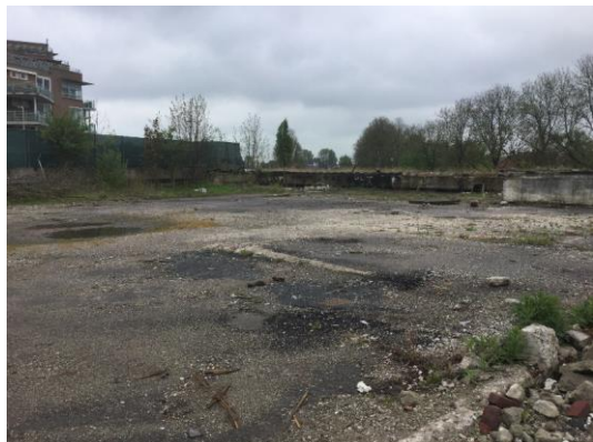
Puin verharding en los asfalt
