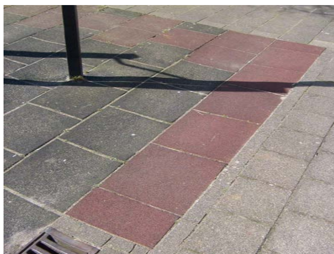
Rubbertegels onder duikelrek zijn deels vernieuwd. (Rubbertegels onder glijbaan liggen deels los.)
