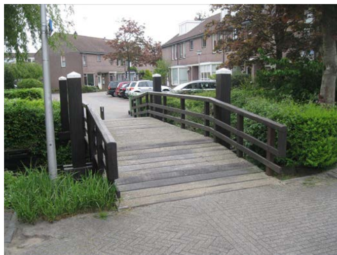
Figuur 13: Brug 14 dient ook te worden vervangen. Door het oliën lijkt de brug in goede staat, maar de hoofdconstructie is sterk aangetast.
